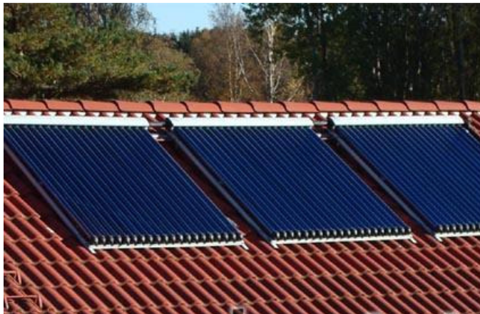
Izgled kolektorjev na strehi.
